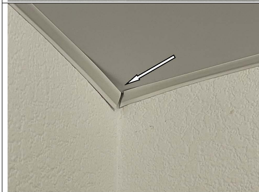
Фото №26. Дефект монтажа гибкой вставки в холле.
