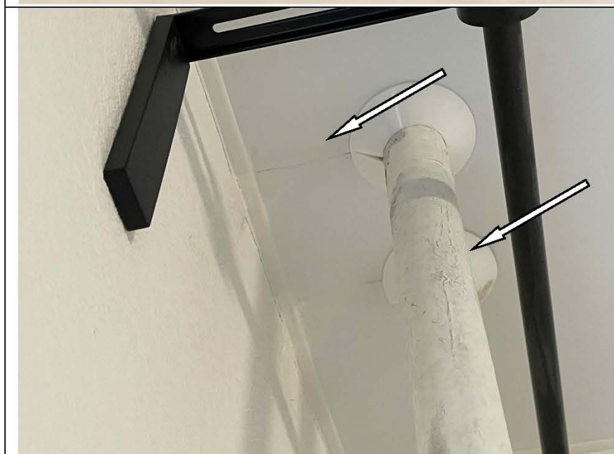
Фото №8. Дефект окрашивания труб отопления в кухне. Дефект натяжного потолка в месте соприкосновения с трубами отопления.
