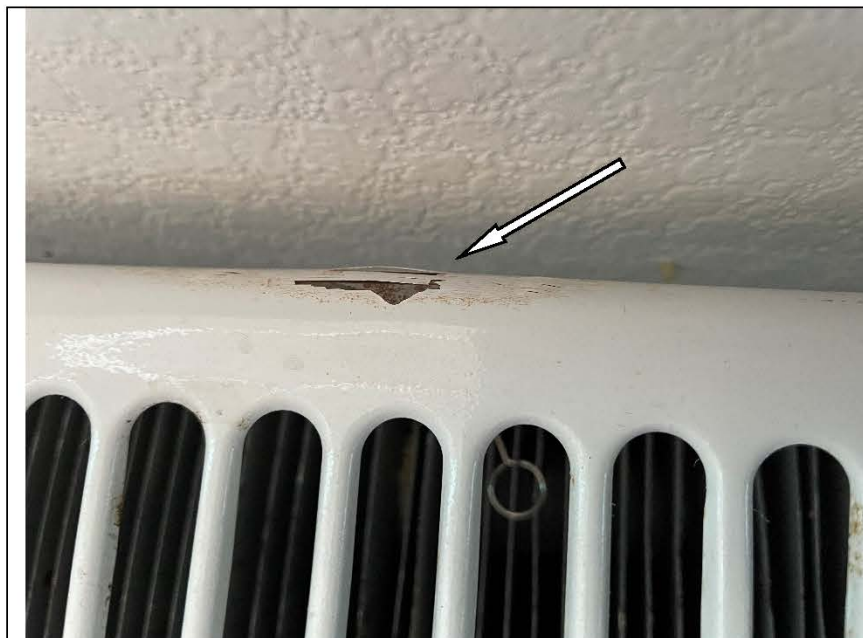
Фото №22. Повреждение кожуха отопительного прибора в кухне.
