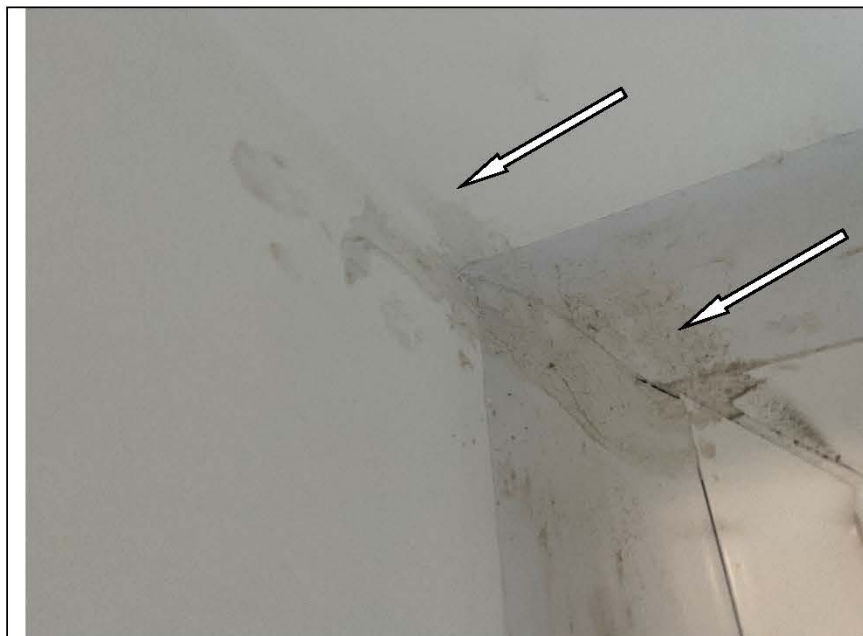
Фото №10. Дефект окрашивания откосов в кухне. Дефект монтажа оконного блока.
