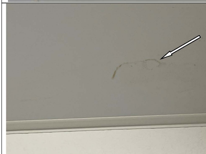
Фото №24. Загрязнение натяжного потолка в холле.
