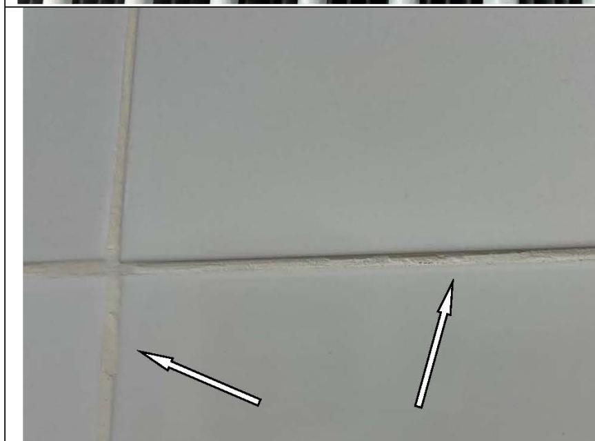
Фото №23. Дефект настенной керамической плитки в ванной комнате (затирка швов).
