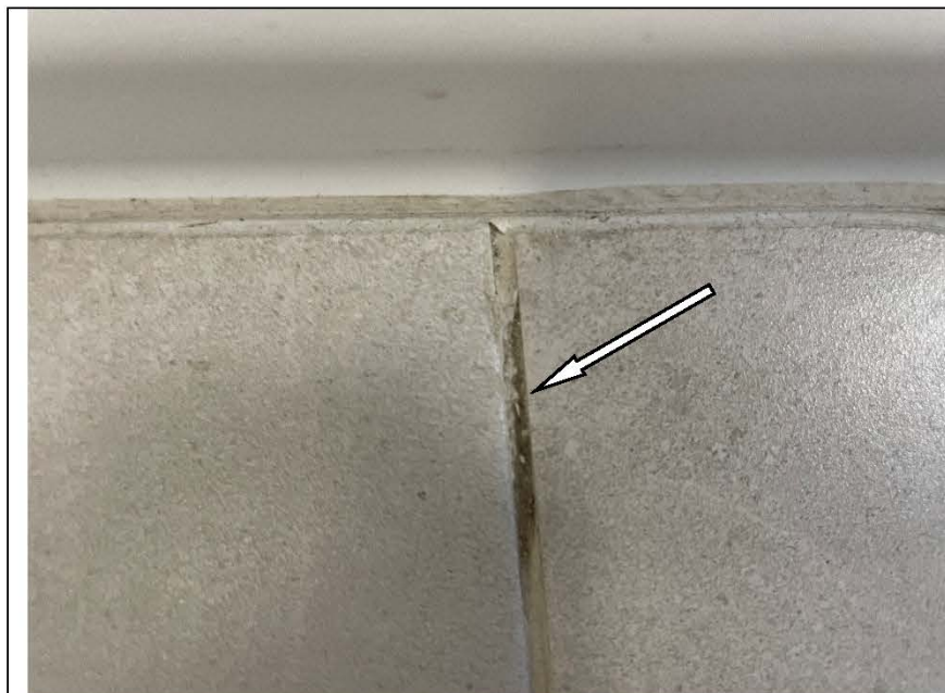
Фото №16. Дефект напольной керамической плитки в холле (затирка швов).
