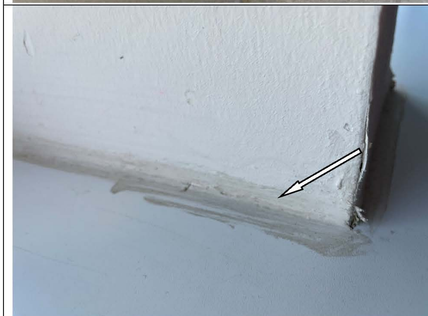
Фото №17. Дефект монтажа подоконной доски в кухне.
