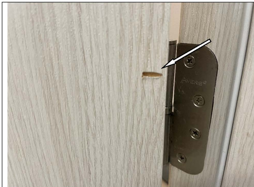
Фото №19. Повреждение полотна деревянной двери в ванной комнате.
