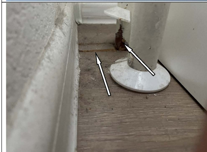
Фото №18. Дефект заделки отверстия для трубопровода в напольном покрытии в кухне. Дефект окрашивания труб отопления в кухне.
