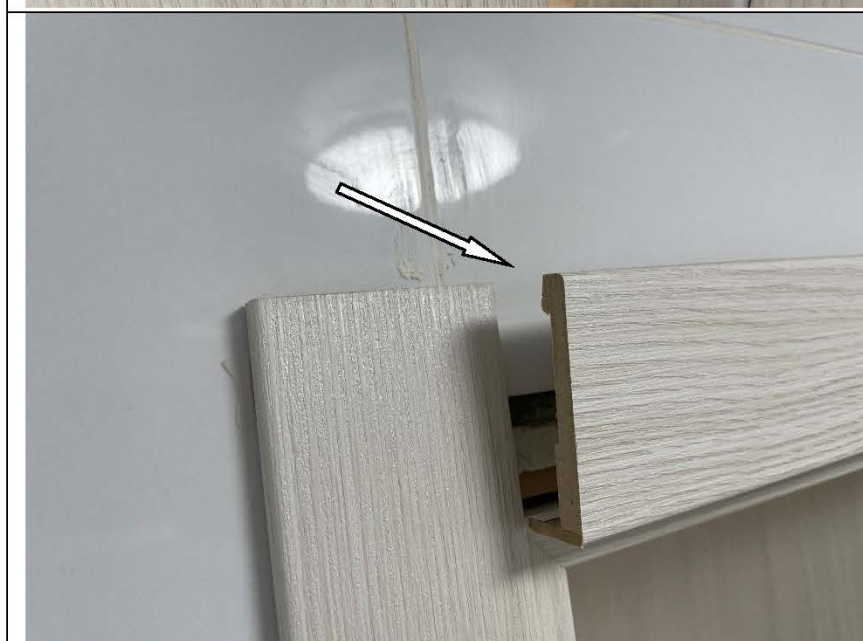
Фото №20. Дефект монтажа дверного наличника в ванной комнате.
